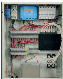
Vue intérieure de l'armoire électrique
