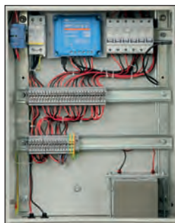
Vue intérieure de l'armoire électrique
