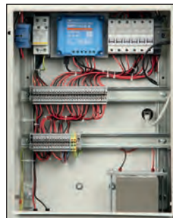
Vue intérieure de l'armoire électrique
