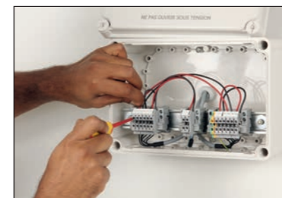
Câblage de la commande et des composants sur BORNELEC1-M (boîtier en face arrière)
