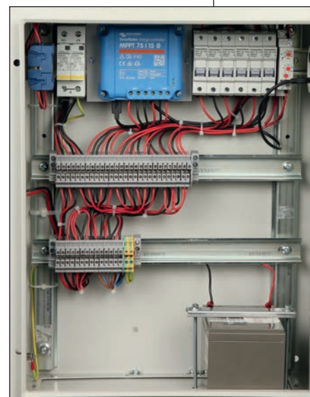
Coffret batterie + régulateur de charge.
