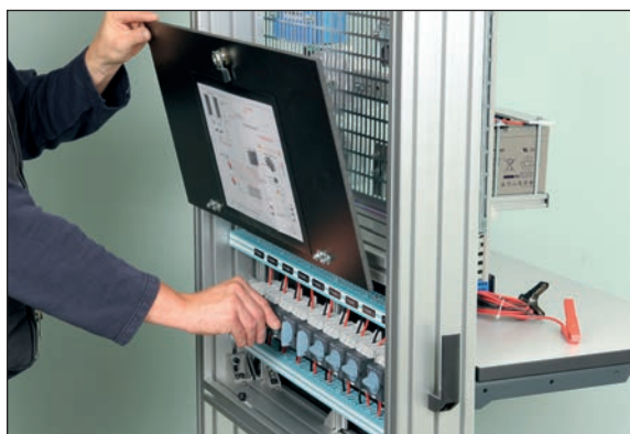
Trappe pour accès aux commutateurs
