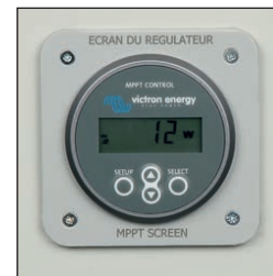
Ecran du régulateur fixé sur le côté de l'armoire
