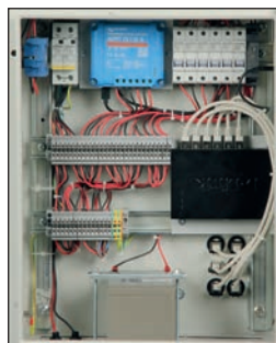
Vue intérieure de l'armoire électrique
