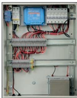
Vue intérieure de l'armoire électrique
