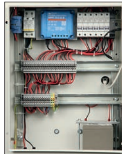
Vue intérieure de l'armoire électrique
