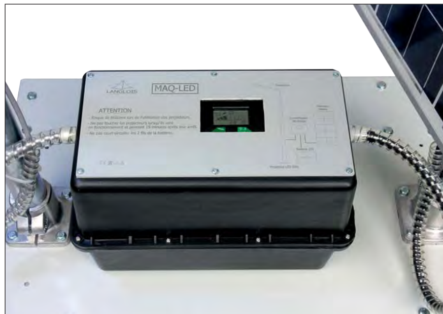
Coffret batterie + régulateur de charge.
