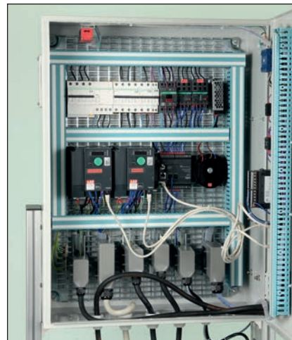
Coffret de commande porte ouverte
